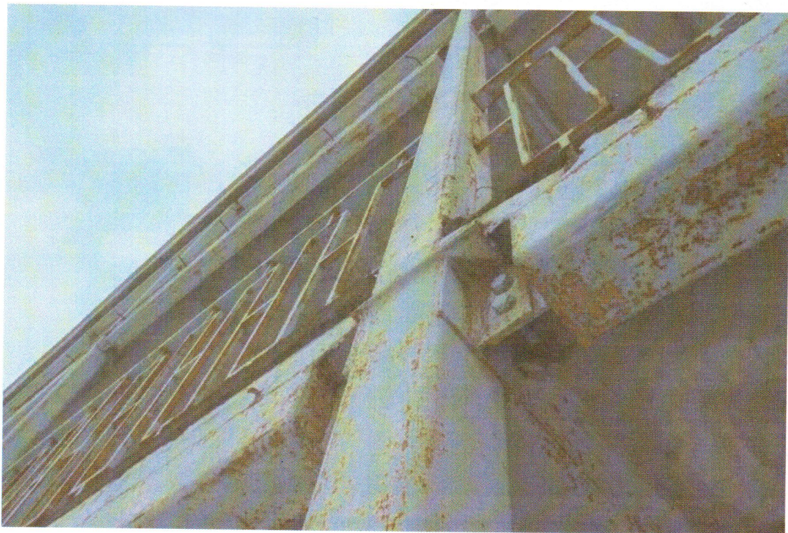
ФОТО №3. Узел сопряжения элементов конструкций. Коррозия
