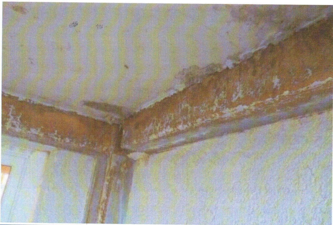
ФОТО №4. Узел сопряжения элементов конструкций. Коррозия
